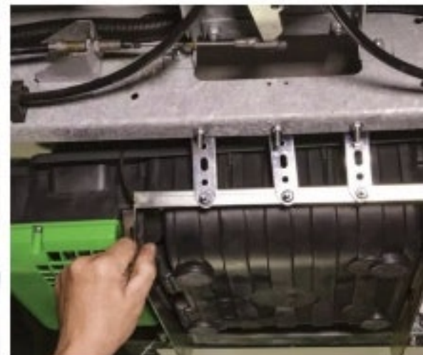
Der Gasgenerator, der 25 A Dauerstrom liefert, hängt unter dem Fahrzeugboden. Gasverbrauch: 290 g/h.
