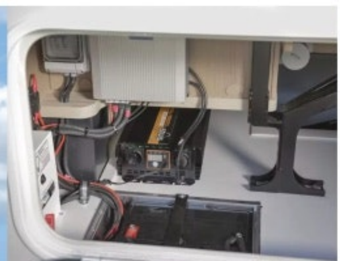
Wechselrichter, Batterieladegerät und die beiden LifePO4-Batterien finden im Doppelboden ihren Platz.
